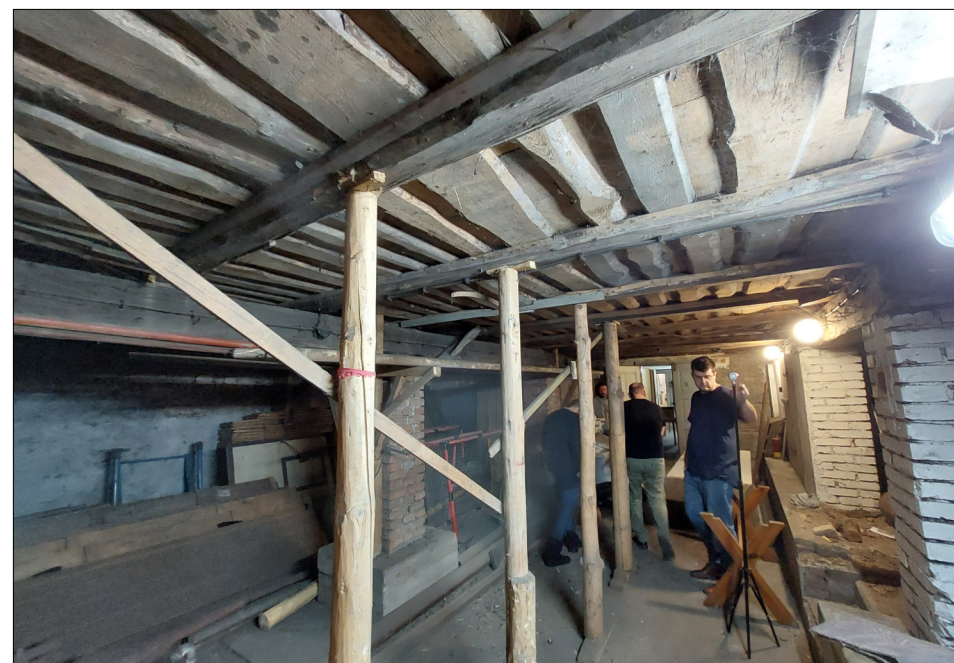
STÁVAJÍCÍ KONSTRUKCE STROPU HLAVNÍHO SÁLU - STATICKY NAPROSTO NEVYHOVUJÍCÍ
